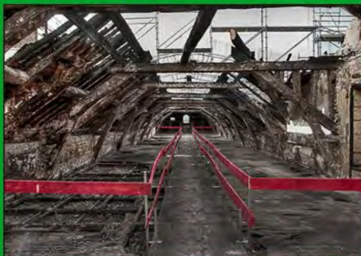
Photographie des combles après incendie (2009)
