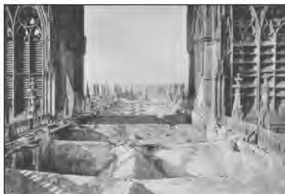
Fig. 10 : Vue des combles après l'incendie.
