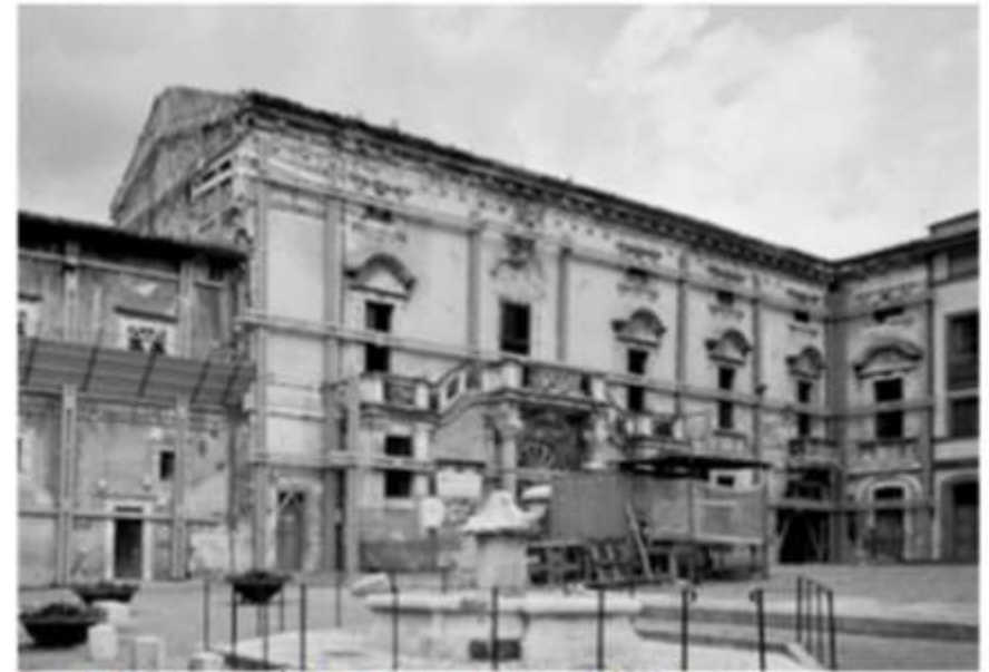
Façade du Palazzo après le tremblement de terre de 2009
