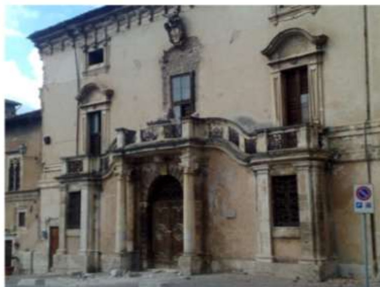
Ampleur des dégâts après le 6 Avril 2009, façade
