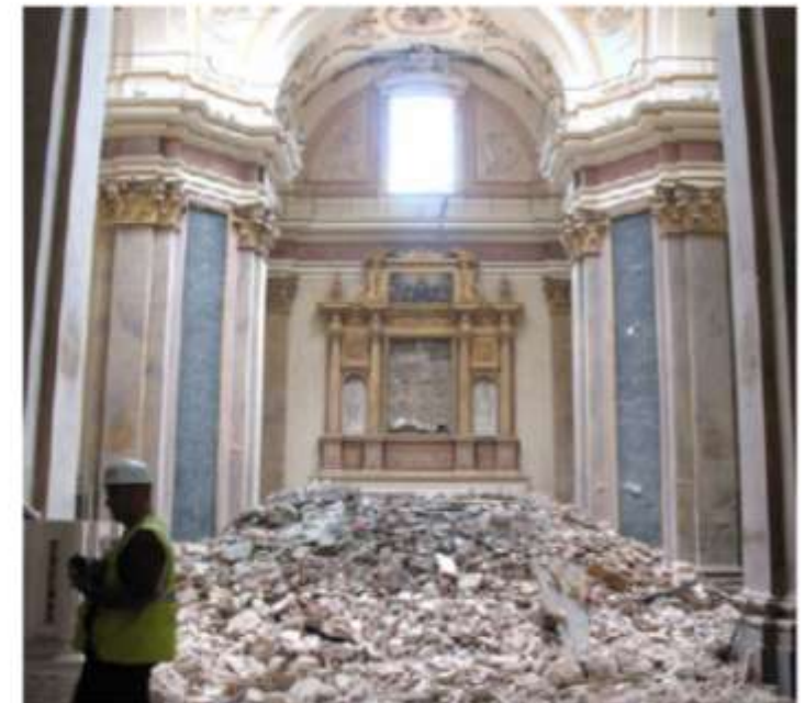
7. Santa Maria del Suffragio, amoncellement de gravats suite à l'effondrement de la coupole. Crédit : Agnès Chodzko – STBI Ambassade de France à Rome.
