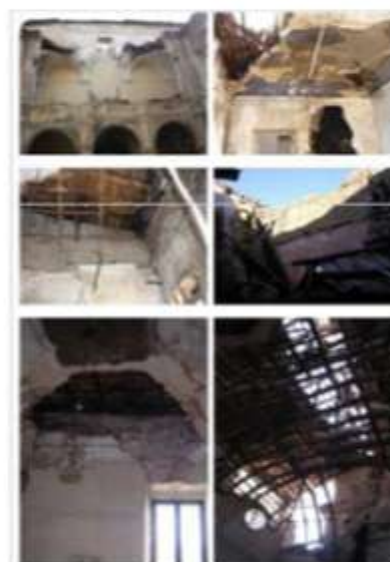
Ampleur des dégâts après le 6 Avril 2009, intérieur
